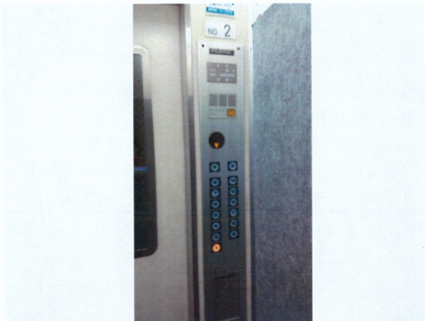
東棟 施工前 かご内操作盤
