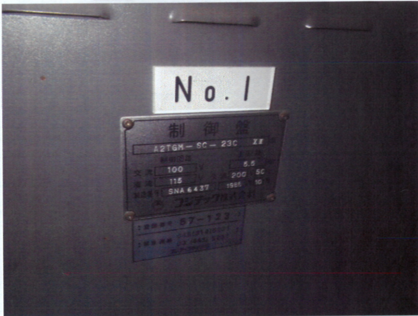
西棟 施工前 機械室内制御 盤型式
