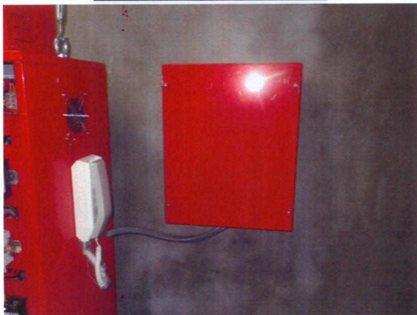
西棟 施工後 機械室内制御 盤 戸開走行保護 装置
