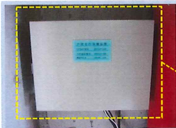
UCMP制御盤(UCMP回路)
